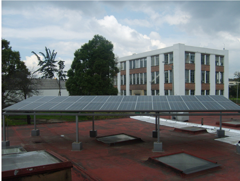
Figura4.1: Fotografía del generador FV instalado en la Universidad Nacional
