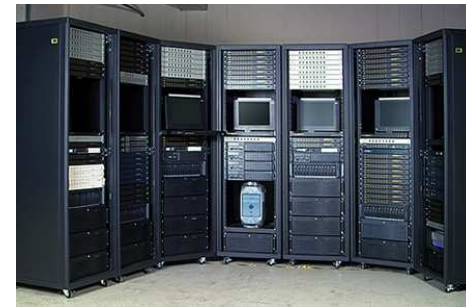
Automatización del edificio manejada por Cuarto de control – Rack de servidores
