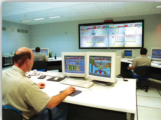
Figura 1.3. Sala de control para realizar la supervisión de procesos industriales
