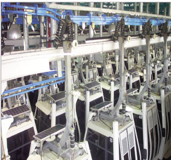
Ilustración 8. Parque de estacionamiento de cabinas. En primer plano se aprecian las pinzas de enganche 10
