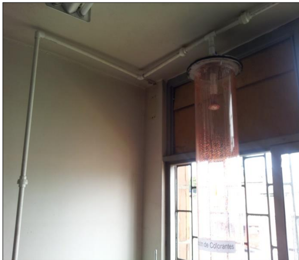
Foto 7-7. Sistema de aspersión
