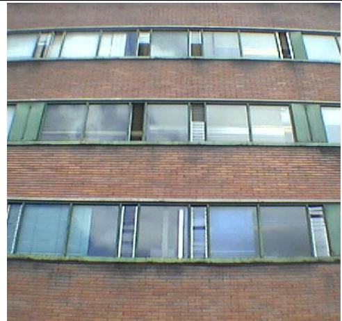
Imagen de la corrosión de la ventaneria metálica. Fuente: Consorcio Obcivil
