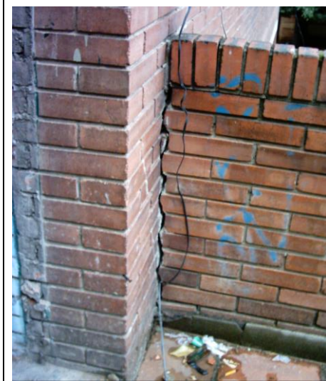
Imagen de muros de ladrillo, afectados. Fuente: Interventoría de la Universidad Distrital F.J. de C.
