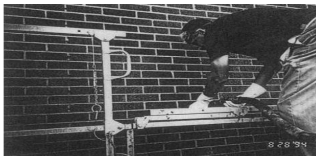
Imagen 3.5.1-1. Reforzamiento con inyección de mortero en la Escuela Primaria en Minland Texas.
