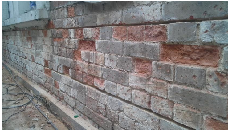
Imagen 6.3.7. Ranura en la zona de la pega. Fuente Imagen propia
