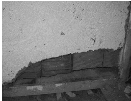
Parete NON rinforzata: fessure per taglio alla base
