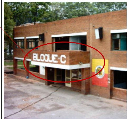
Imagen de la deformación de la placa, en la zona del balcón . Fuente: Interventoría de la Universidad Distrital F.J. de C.
