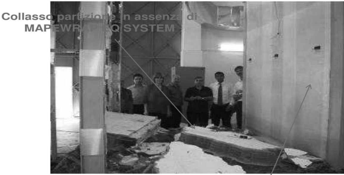
Imagen 3.2.4-1. Ensayos del sistema "MAPEWRAP EQ SYSTEM". Fuente . Fuente: MORANDI, G. La Facultad de Ingeniería de la "Università degli Studi di Napoli Federico II. Italia: s.n., 2013
