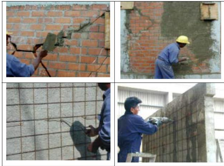
Imágenes 3.2.1-3., 3.2.1-4., 3.2.1-5., 3.2.1-6. Proceso de reforzamiento con grapas, malla electro-soldada y pañete. Fuente: SAN BARTOLOMÉ, A., ARATA, A. y DÍAZ, V. Investigación, arriostramiento de tabiques de albañilería existentes en fachadas de edificios con voladizos. Universidad Católica del Perú . [En línea] 2007. Disponible en web: < http://blog.pucp.edu.pe/media/688/20070424-Arriostramiento%20de%20tabiques%20existentes.pdf >.
