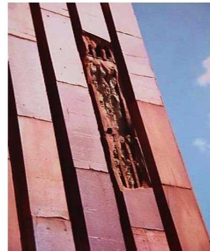
Imagen de los desprendimientos. Fuente: Proyectistas Civiles Asociados- PCA
