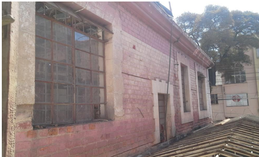
Imagen 6.5.3, estado de los muros de la fachada lateral, luego del sismo del 10 de marzo de 2015 . Fuente Imagen propia
