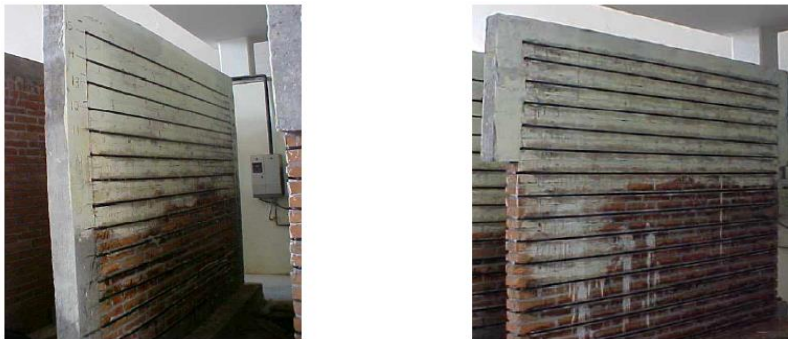
Imagen 3.1.3-1. Métodos TR2 y TR9 aplicados en muros de 2,60 m de largo y 2,30 m de altura. Fuente: RAMÍREZ, H. y CARREÓN, B. Experimental study on masonry walls strengthened with steel and plastic straps . Vancouver, B.C., Canadá: s.n., 2004. 13th world conference on earthquake engineering. Paper No.
