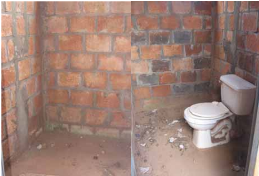
Foto 64-65: Baño del proyecto VISR. Villa Adriana Primavera Vichada
