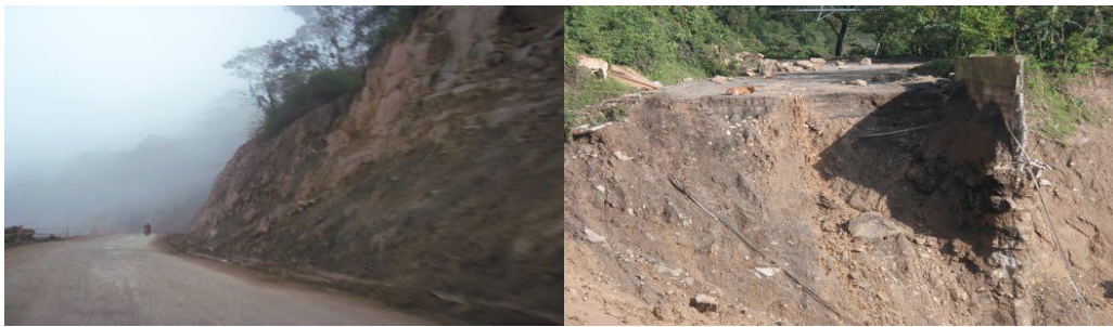
Figura 4-12: Alto de la Mona Derrumbe vía a Honda
