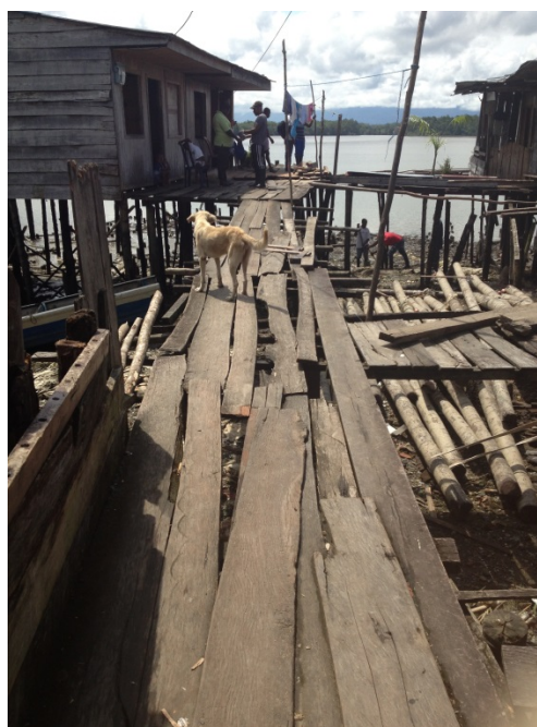
2. El puente está quebrado. Esta era la situación de los puentes del barrio Alberto Lleras Camargo antes de la acción de servicio social.
