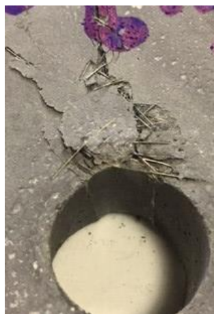
Figura 6. Falla por cortante en conexión en UHPFRC. (Fuente propia)
