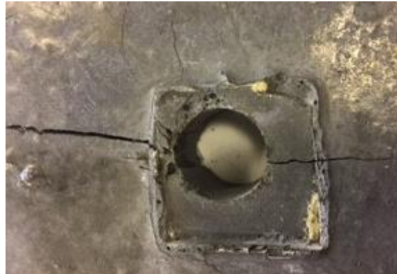
Figura 5. Falla por tensión en UHPFRC. (Fuente propia)
