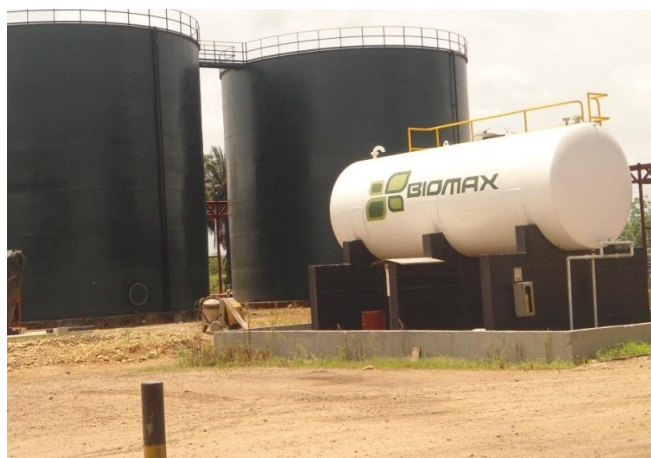
Ilustración 16: Tanque de almacenamiento combustible en Guaicaramo S.A.
