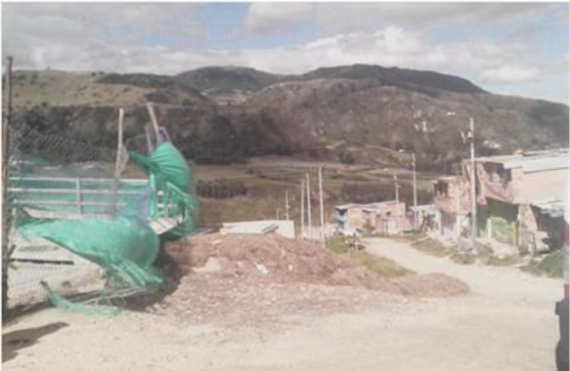
Fotografía -4: Construcciones ilegales
