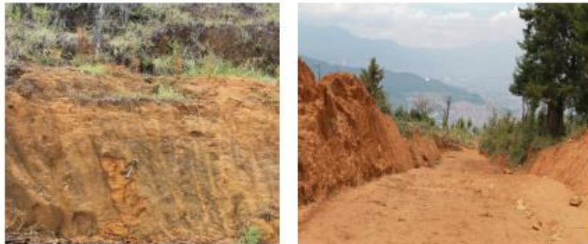
Figura 9. Suelo residual de Dunita observado en cortes de vía y apiques. Tomado de (DEACIVIL S.A.S, 2013)
