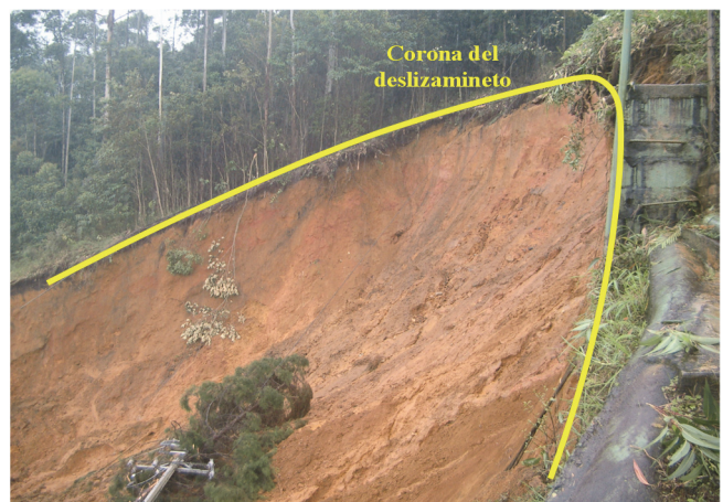
Figura 3. Vista de la corona del deslizamiento. Fuente: Los autores
