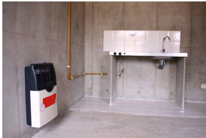
Figura 7-9: Instalaciones a gas para cocción y calefacción en proyecto Plaza de La Hoja [66].
