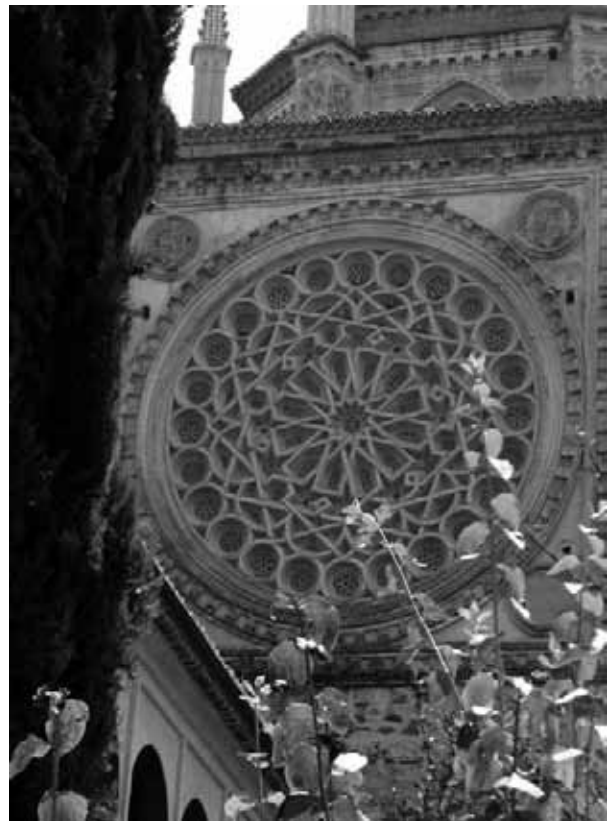
Figura 4. Aspecto que presenta el rosetón realizado en ladrillo aplanillado recubierto por un mortero fino de cal y arena, dibujando una lacería mudéjar. Fotografía de Pilar Mogollón.
