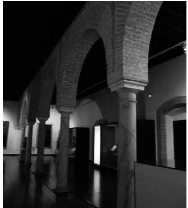
Figura 14. Sala alta de la antigua enfermería que hoy forma parte del itinerario expositivo del Museo Santa Clara de Zafra, Badajoz. Las directrices restauradora imperantes desde la primera mitad del siglo XX, de dejar los materiales vistos, se mantiene en los inicios del siglo XXI, como apreciamos en esta reciente intervención. Fotografía de Pilar Mogollón.
