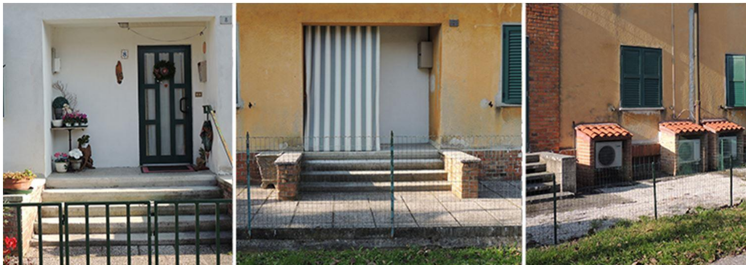
Figura 11_Case operaie tipo 4-4bis. Modifiche ai fronti: tamponamento porta d'ingresso (sinistra); apposizione tende parasole (centro); inserimento piccole cavità esterne per l'inserimento dell'unità di trattamento dell'aria esterna (U.T.A) (destra).
