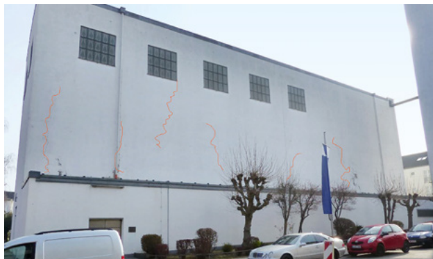
4. St. Fronleichnam, Kartierte Risssschäden an der Südfassade. Archiv Hahn Helten + Thiemann Bauleitungs GmbH, Aachen.
