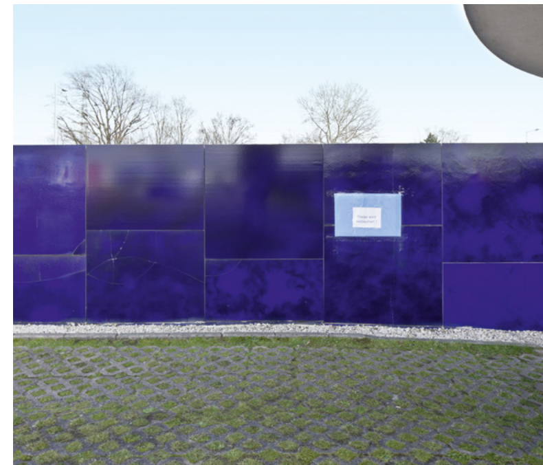
4. Frechen, Keramion. Schäden an den KerAion-Platten. Foto: Silvia Margrit Wolf, LVR-ADR, 2014.
