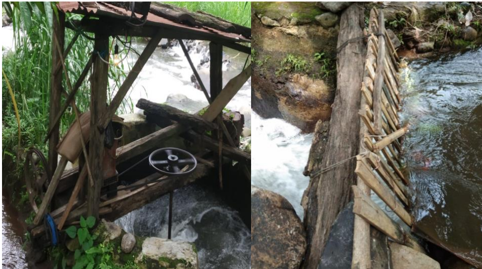
A. Pembangkit Listrik Tenaga Vortex B. Saluran Bendungan Irigasi
