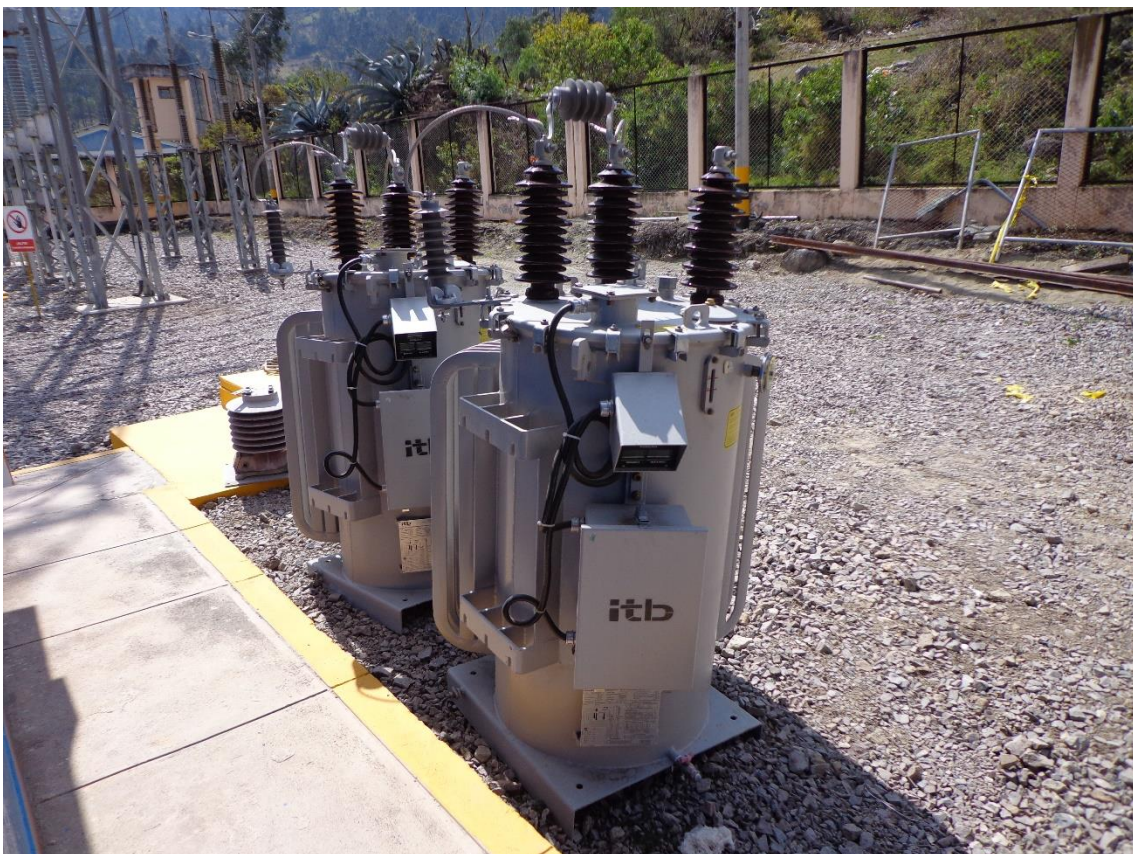
Figura 14: Reguladores de tensión instalados en el alimentador TA-05
