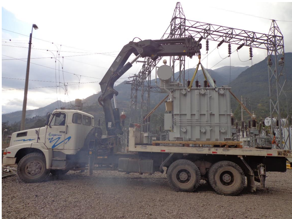
Figura 6: Camión transportando el transformador de aprox. 8 toneladas
