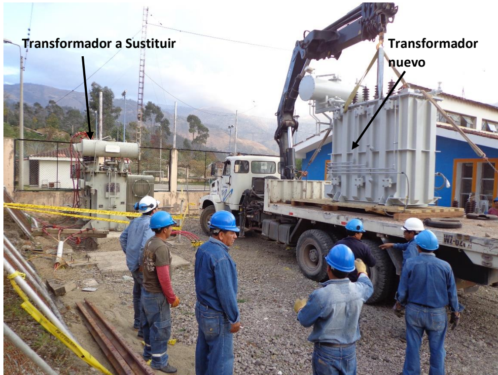
Figura 7: Vista de ambos transformadores
