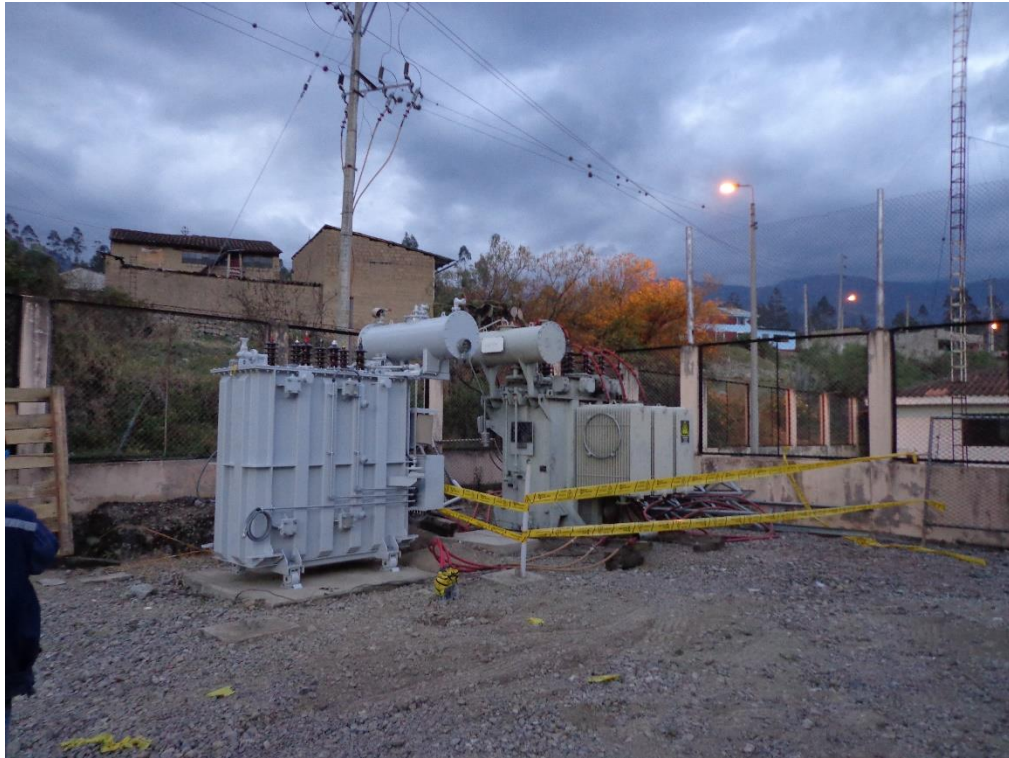
Figura 9: Vista de transformadores puestos en lugar de operación.
