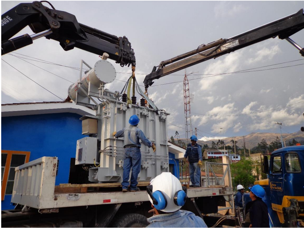
Figura 5: Transformador ubicado sobre camión grúa para su transporte al punto de instalación.
