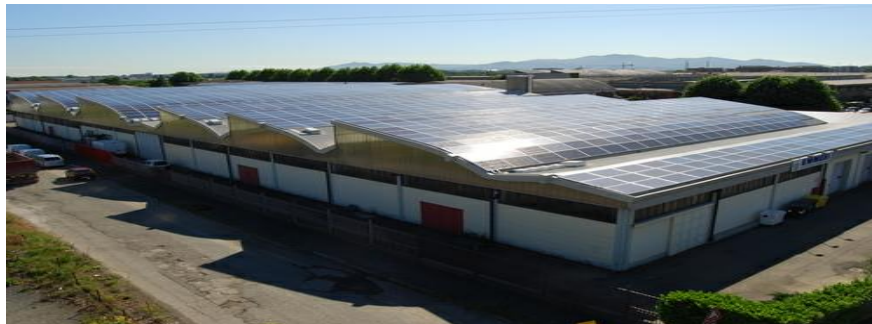
Figura 11. Techo tipo sierra con cubierta de paneles solares.
