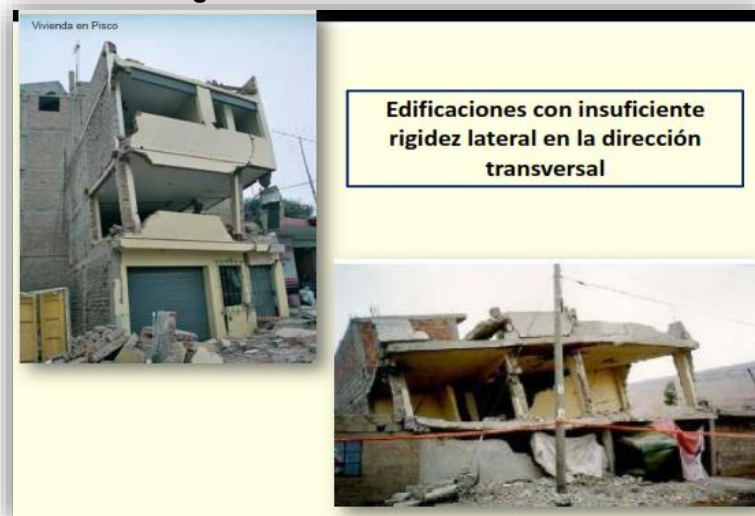
Figura 11: Fallas en la dirección transversal
