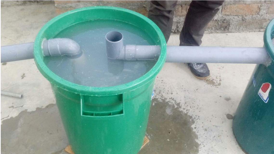
Fotografía 13. Vista del tanque primario.
