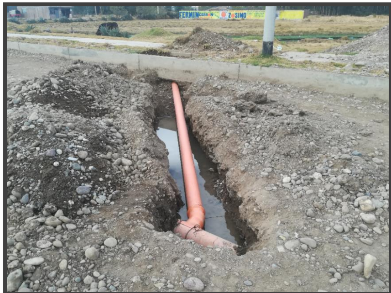
FIGURA N° 19: Conexiones domiciliarias con presencia de N.F.S.
