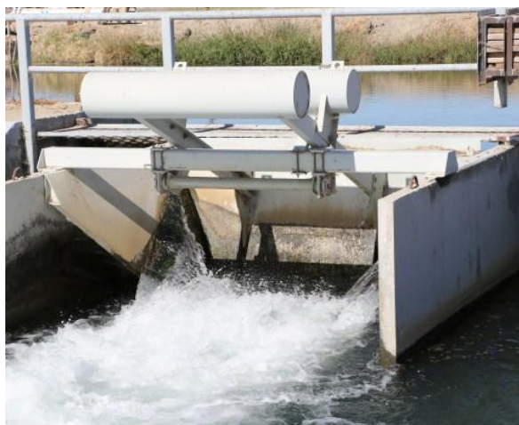
Figura 2.20. Compuerta de inclinación automática.
