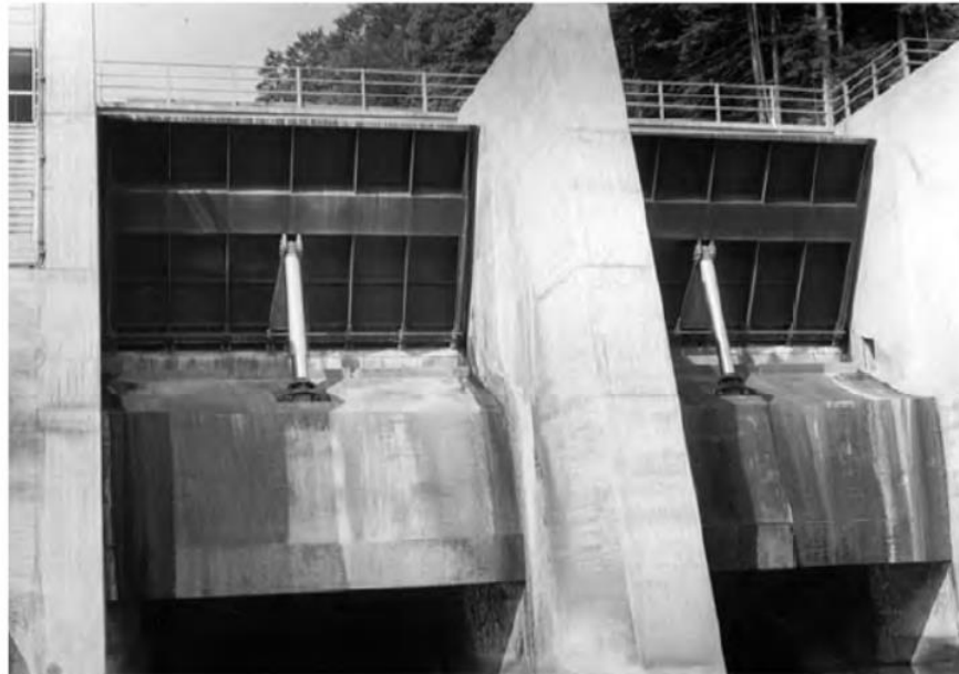
Figura 2.19. Pistones hidráulicos para las compuertas de la presa de Sihlhofe dam (ZWAG) [6].
