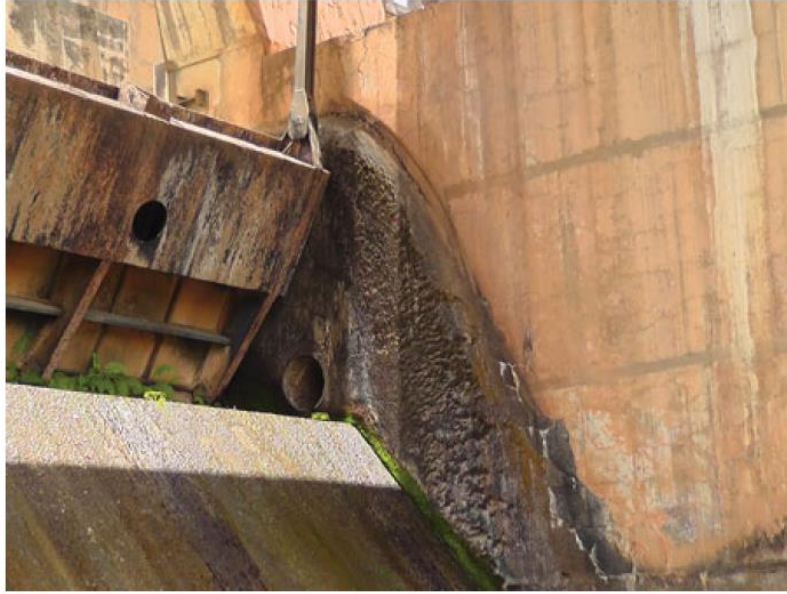
Figura 3.1. Compuerta tipo clapeta existente.
