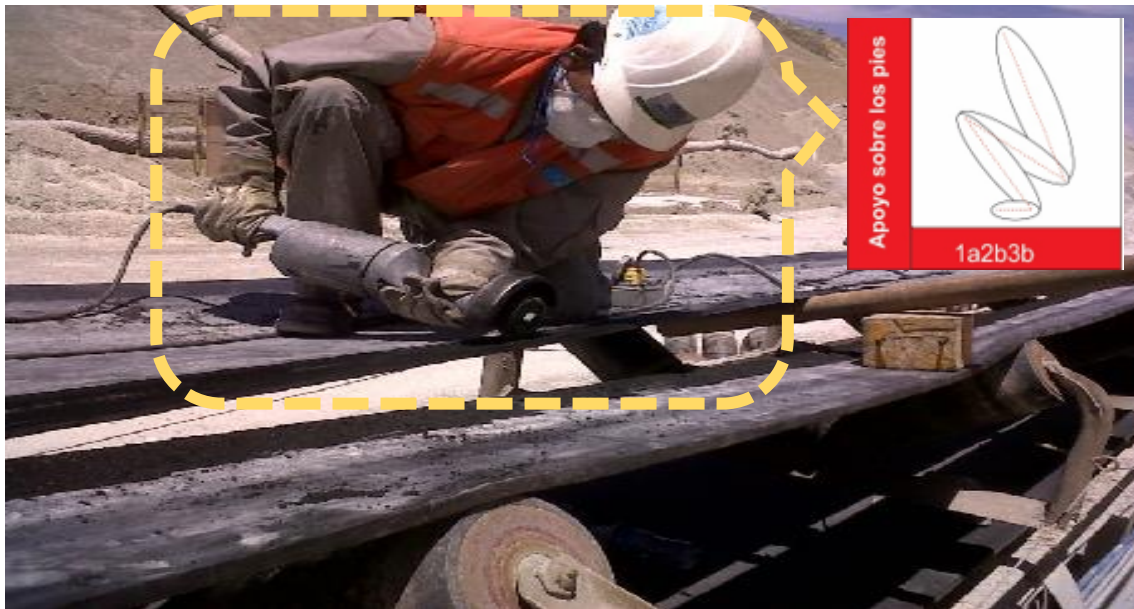
Figura 9. Corte de partes deterioradas de la faja
