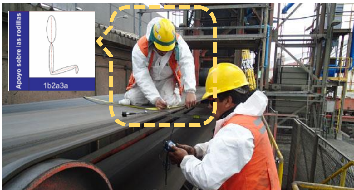
Figura 8. Marcado de las partes deterioradas de la faja transportadora
