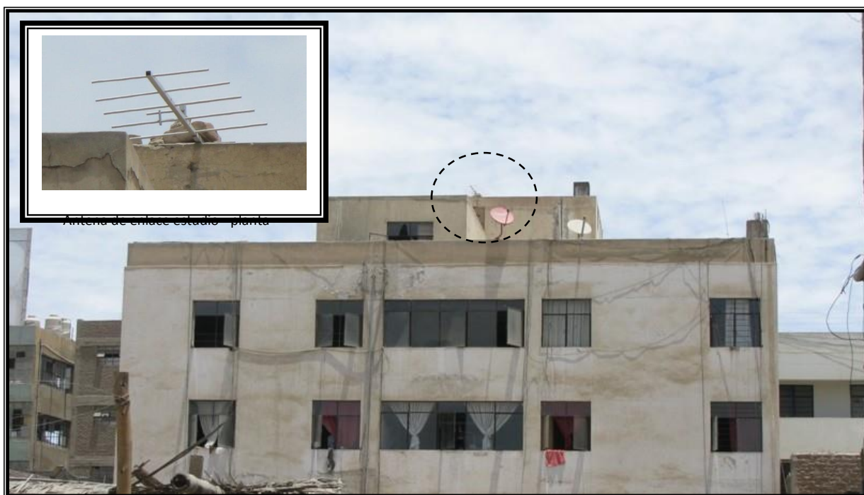
Parte posterior del edificio que muestra un enlace ilegal (estudios)
