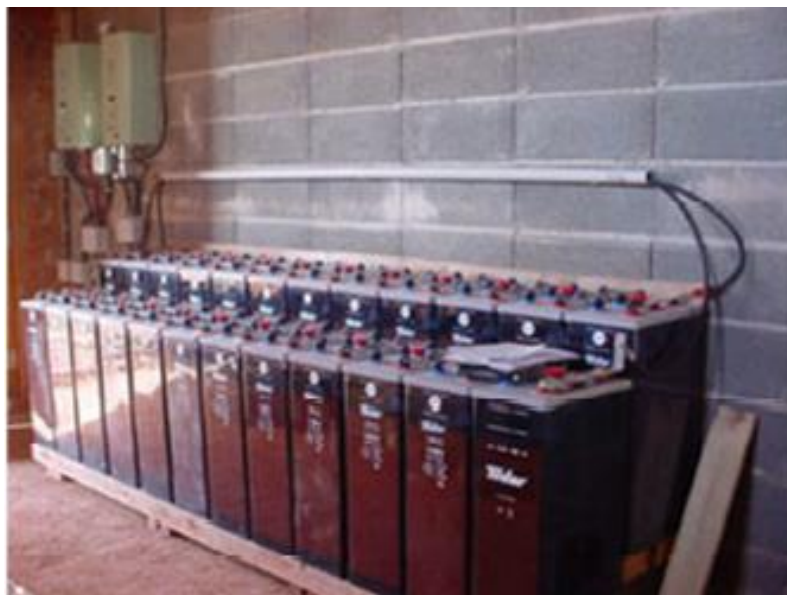
Figura 16: Banco de baterías. (López, 2015, pág. 26)
