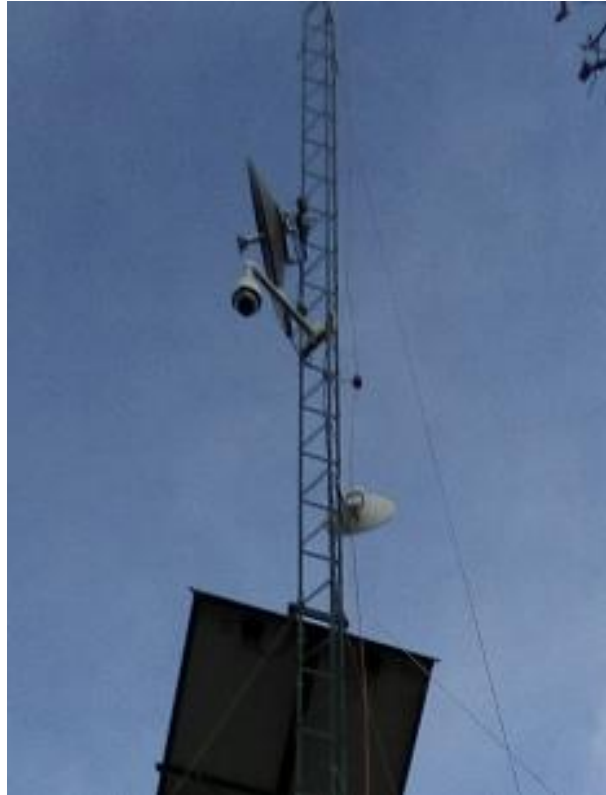
Figura 55: Cámara IP PTZ instalada.
