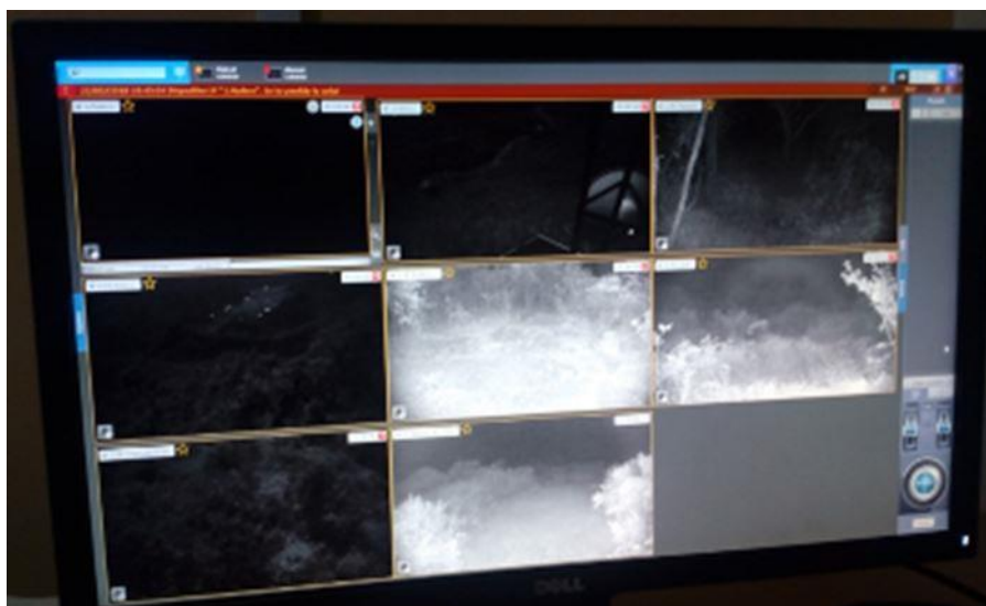
Figura 58: Cámaras en operación nocturna.
