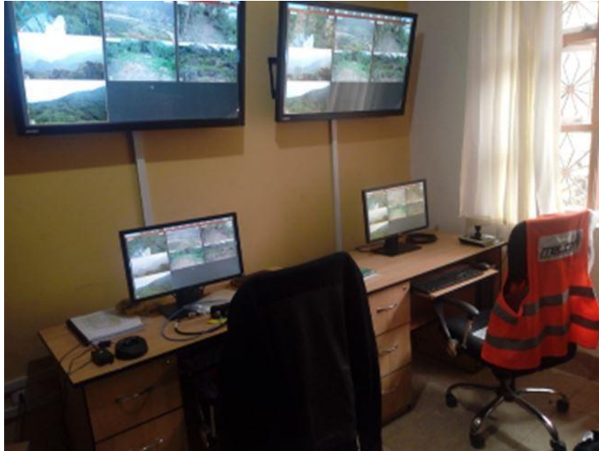
Figura 56: Centro de control Fuente: Propia
