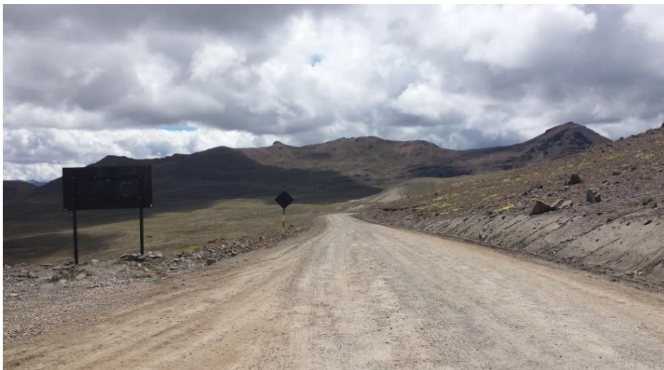
Fotografía 2. Infraestructura de la carretera en la provincia de Espinar, en su mayoría el tramo de la carretera Mina Constanza – Matarani en este estado.
