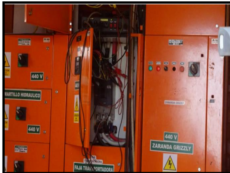
Figura 60. Contacto con corriente eléctrica.
