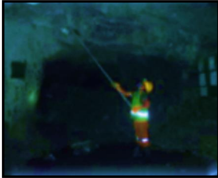
Figura 59. Esfuerzo excesivo o forzoso.
