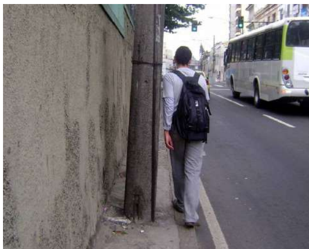
Figura 5. Poste colocado no meio de calçada estreita.
