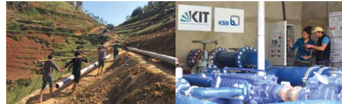
Um die Bevölkerung auch in der Trockenzeit zuverlässig mit Trinkwasser versorgen zu können, entwickelte das interdisziplinäre Team eine spezielle Anlage in Seo Ho
