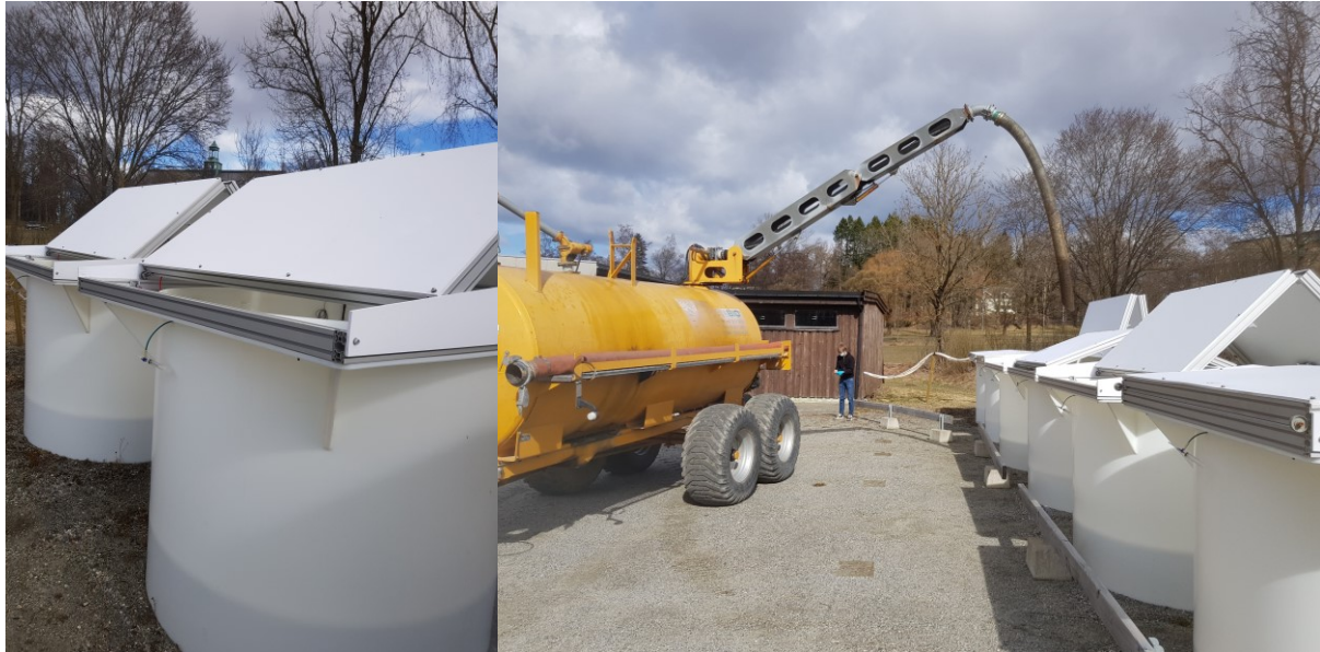
Bilde 13. Repliserte 5m 3 forsøkskummer med motordrevne deksler og automatisk GHG overvåkning ved NMBU, Ås. Foto Peter Dörsch, NMBU.
