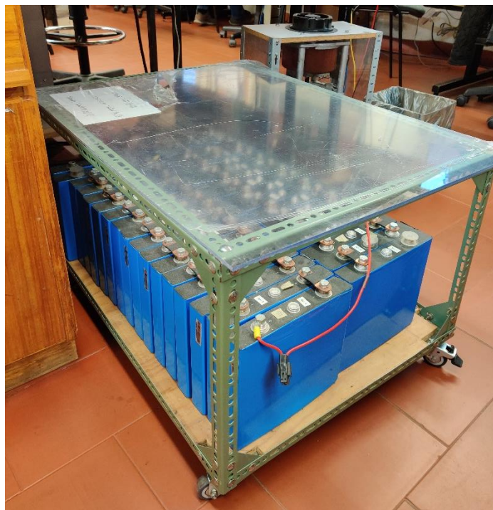
Figura 6.18 – Conjunto de baterias (IFP 36230218-100Ah) utilizado no teste de carregamento.
