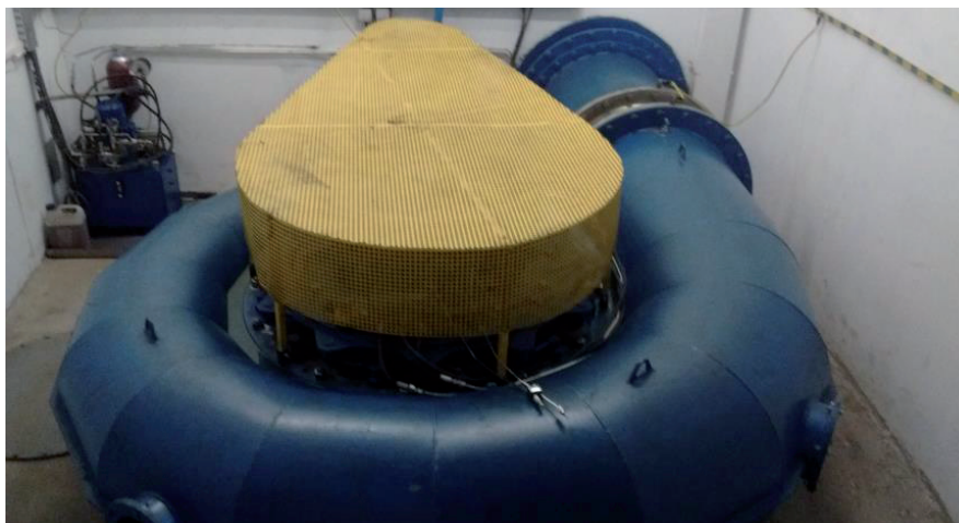
Rys. 52. Wnętrze hydroelektrowni w oczyszczalni ścieków w Toruniu (fot. B. Igliński)
