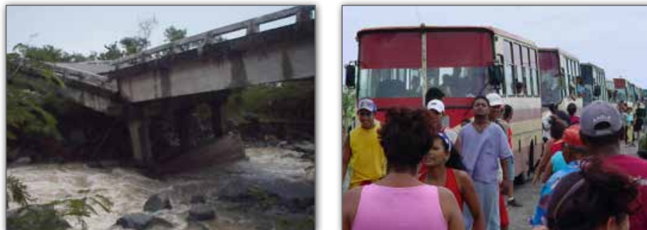
Figura 11. Daño estructural a uno de los puentes de Guamá tras el paso de Ike y proceso de evacuación de la población
