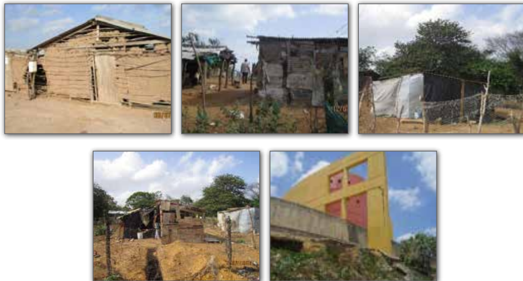
Figura 9. Estado de vivienda y edificaciones que muestran la vulnerabilidad estructural presente en el municipio costero de Riohacha
