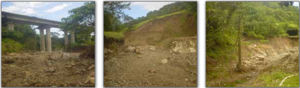
Figura 7. Afectación en la base de la alcantarilla y del pedraplén del ferrocarril en el lado norte antes de cruzar el puente situado sobre la carretera central
