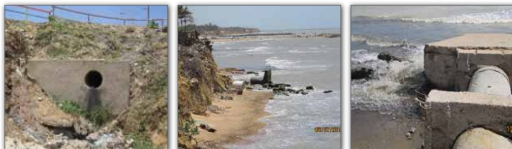
Figura 10. Pésimo estado de la red de alcantarillado del municipio costero Riohacha
