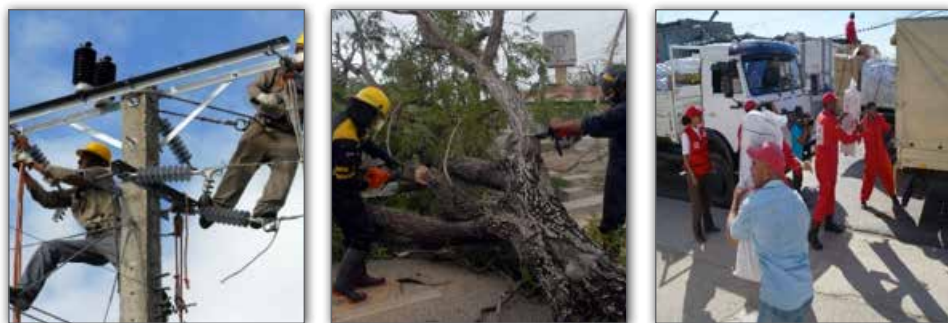
Figura 13. Proceso de recuperación después del paso del huracán Sandy
