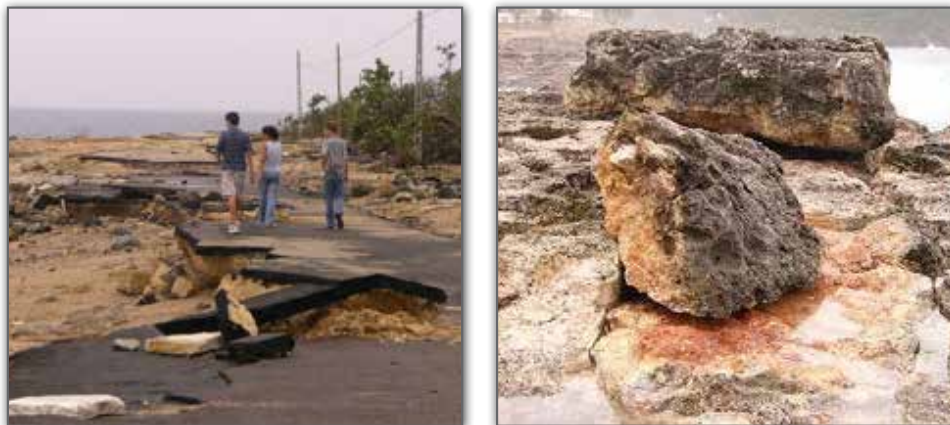
Figura 5. Afectación producida por el huracán Dennis y presencia de huracanolitos que arrojó el mar
