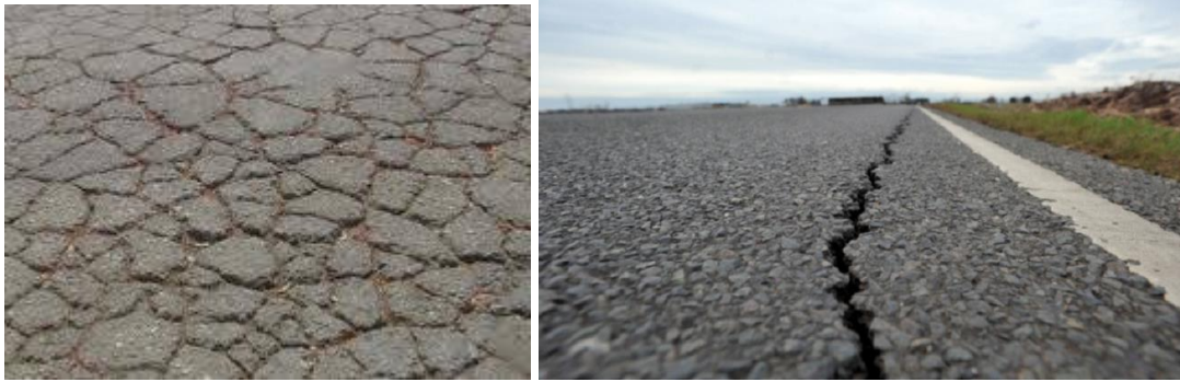
FIGURA 12. AGRIETAMIENTO POR FATIGA
