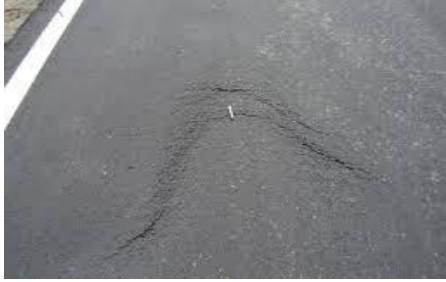
FIGURA 13. AGRIETAMIENTO POR TEMPERATURA
