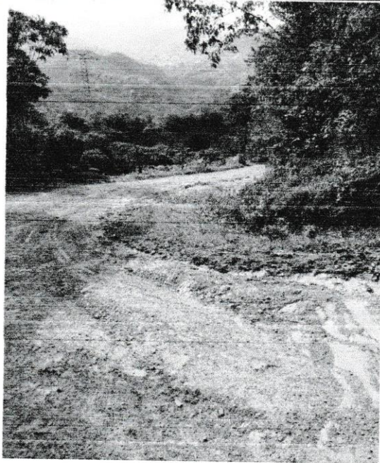
Deterioro Gral en curvas
