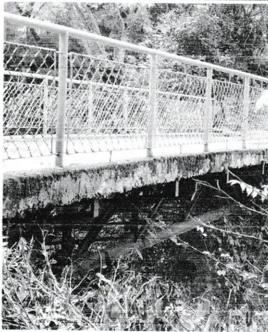
Puente estructura debilitada
