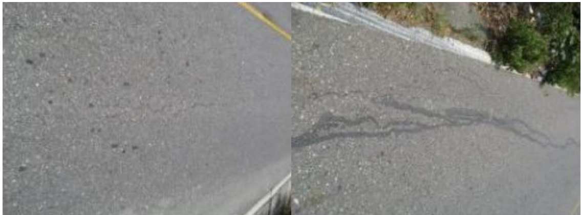
Figura N°36. Daños pavimento Vía Soata – Puente Pinzón
