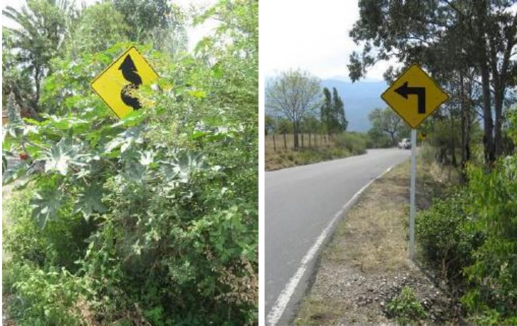
Figura N°5 Estado de la señalización vial del estado de la vía K0 +600 y K6+850 sentido Soata – Sector Puente Pinzón.
