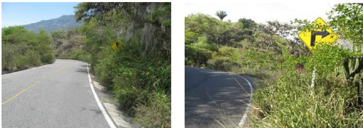
Figura N°37. Estado señalización Vía Soata – Puente Pinzón K2+500 y K3+105
