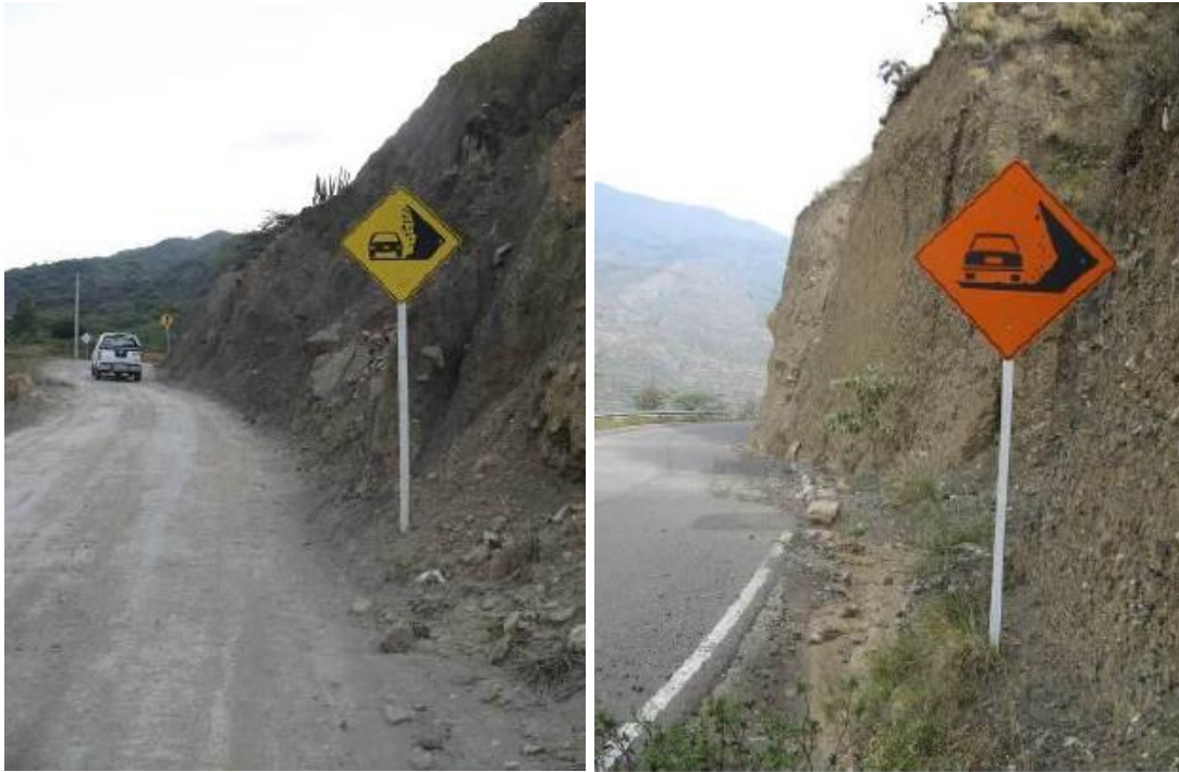
Figura N°40. Zonas inestables vía Soata – Puente Pinzón K2+500 y K3+105
