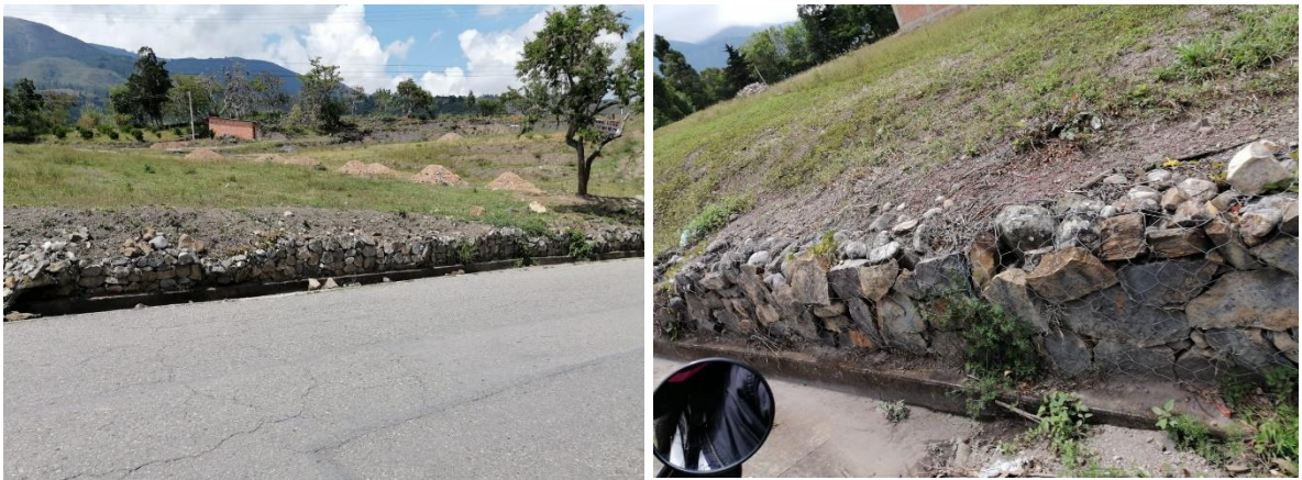
Figura N°25. Gavión destruido por construcción de barrio Soata – Sector Puente Pinzón K0+280
