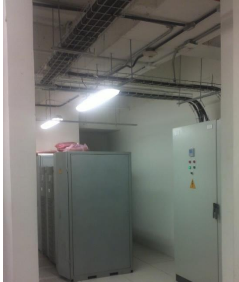
Ilustración 30. UPS y Tableros eléctricos
