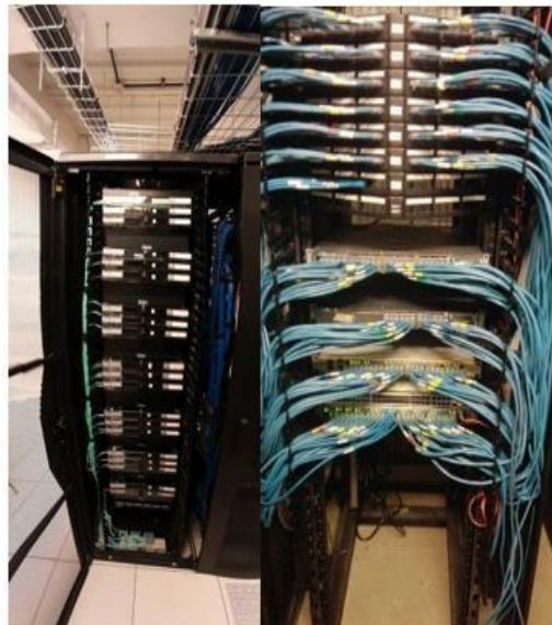
Ilustración 31. Centros de cableado
