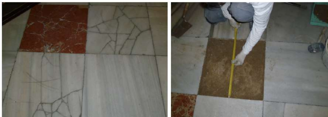
Figura F10: Detalle del proceso de reparación de la solería de la iglesia en el año 2019 (Fuente: Rafael Salido).
