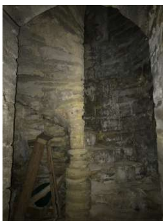
Figura 2.7: Vista de la escalera de la iglesia de Nuestra Señora del Soterrano en Aguilar de la Frontera. (Fuente: fotografía de la autora).
