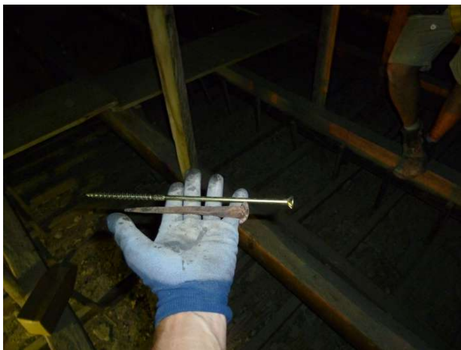
Figura F6: Detalle de clavo de las cubiertas descubierto y el tornillo empleado en la restauración de 2013. Parroquia de Santiago Apóstol (Fuente: Rafael Salido).
