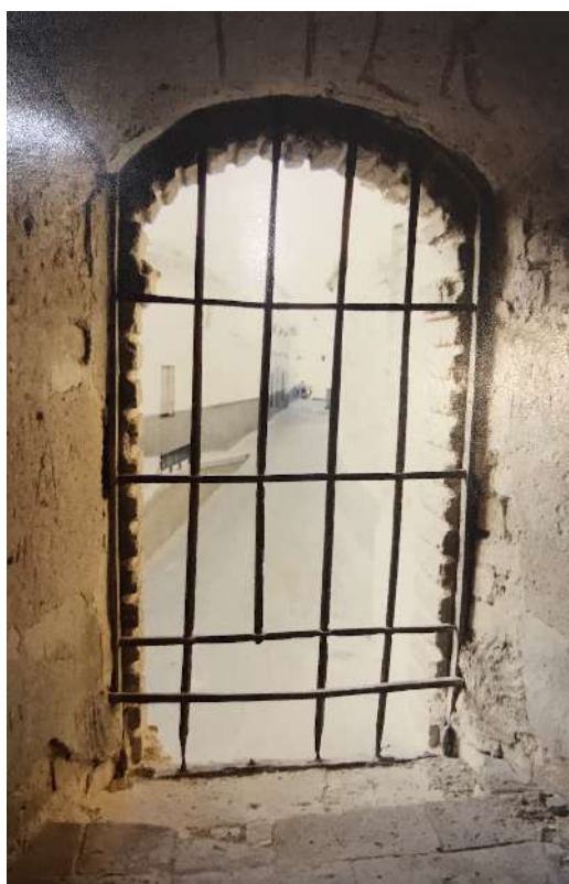
Figura 3.76: Detalle del estado de una ventana de la torre. (Fuente: A.C.C.C.P.H.A. A9.004/14, s.f.).
