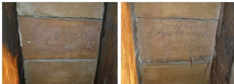
Figura 3.95: Detalle de firmas de antiguos obreros en las cubiertas. (Fuente: fotografías de Rafael Salido).
