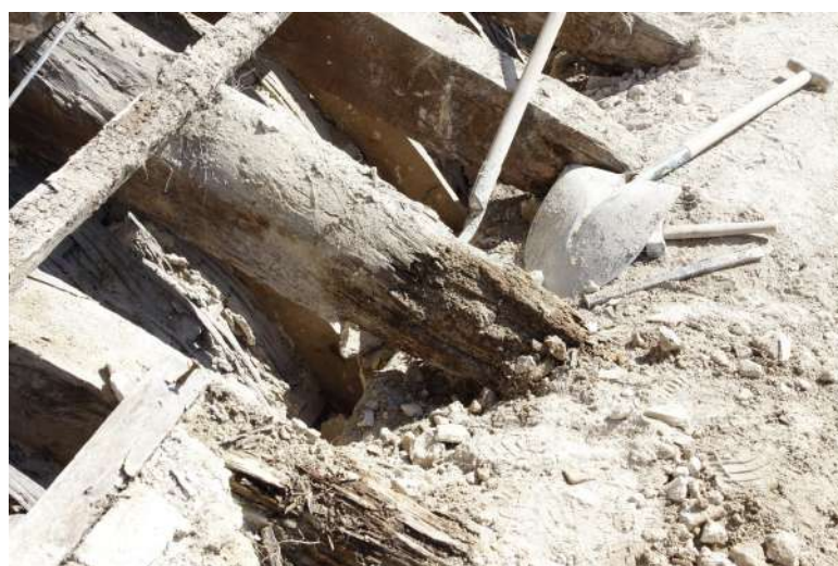
Figura 3.94: Detalle del estado de las cabezas de las vigas. (Fuente: fotografía de Rafael Salido).
