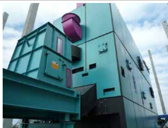
Joonis 6. AS Kuressaare Soojus uus soojuse ja elektri koostootmisjaam. F
