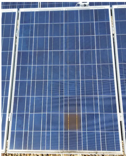
Figura 53 - Módulo com célula visivelmente danificada.
