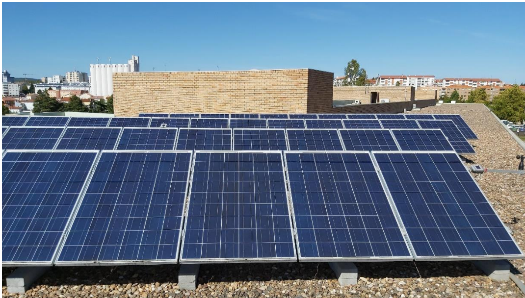
Figura 25 - Sistema fotovoltaico da cobertura da ESTiG.
