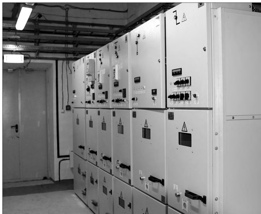
Новое оборудование подстанции.
