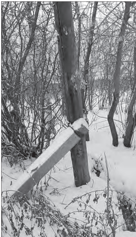
Деревянная опора растрескалась.
