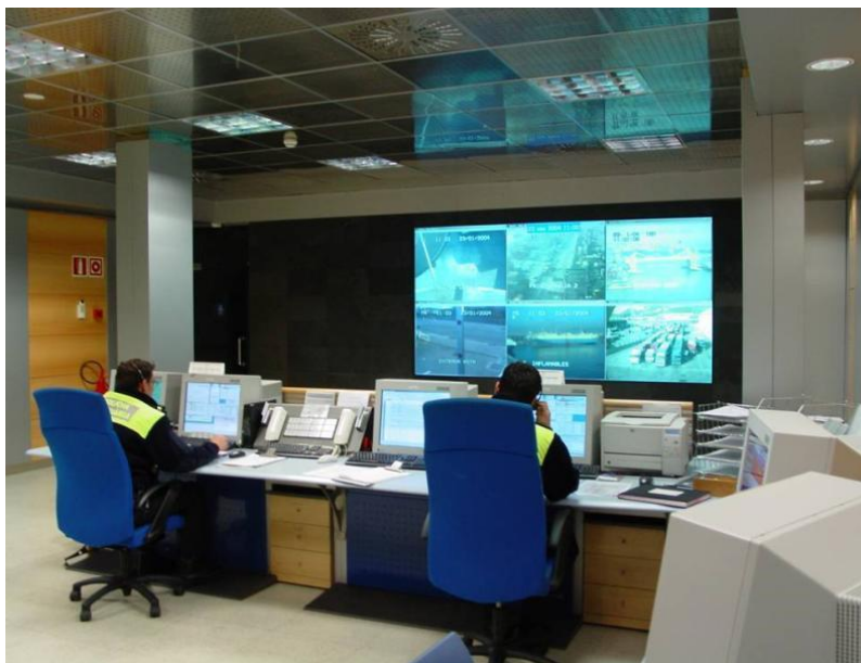
· Imatge 5: Centre de Control del Port de Barcelona.
