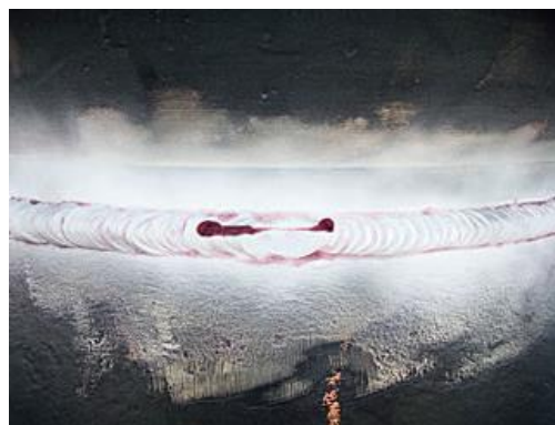
Figura 26: Grieta detectada en un cordón de soldadura mediante penetrantes coloreados.
