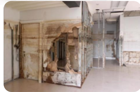
Image 46. Intérieur d'une usine touchée pour des inondations de 2011
