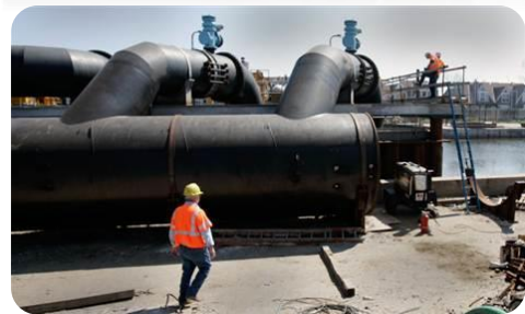
Image 63. Station de pompage située à la Nouvelle Orléans.
