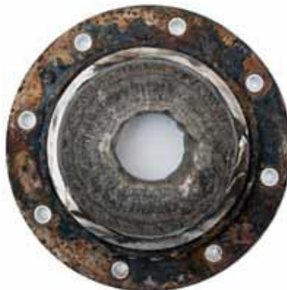
Figura 5.4. Detalle de una conducción parcialmente obstruida por estruvita (Ostara, 2015).
