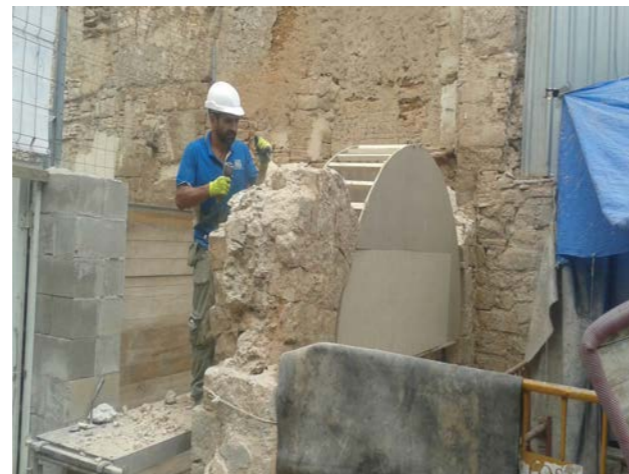
Figura 46: un cop les dovelles desmuntades s'inicia la retirada de les pedres de les pilastres de l'arc (Font pròpia)
