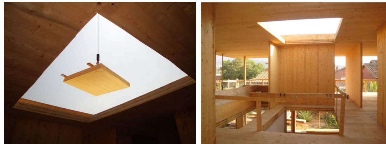
Figura 39: modificació estructural d'un habitatge a Martorelles (Font: Projecte As Buit d'un habitatge unifamiliar aïllat, Martorelles)
